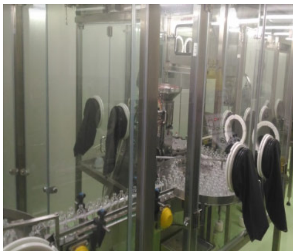
HEPA 層流無菌充填作業區域
